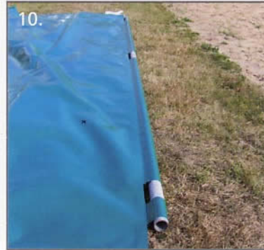
10. Nach dem Ausbreiten der Dachfolie werden auf beiden Seiten die Abspannrohre in die Folientasche eingeschoben.
